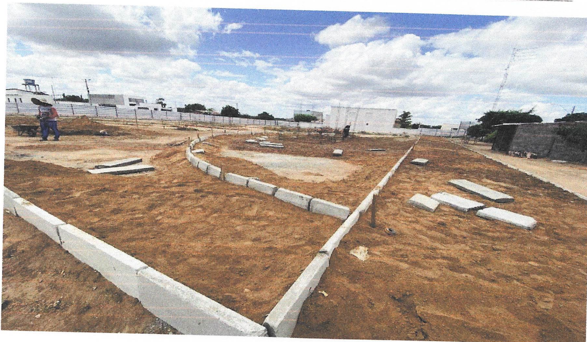
Foto 09 – ASSENTAMENTO DE GUIA (MEIO-FIO) EM TRECHO RETO, CONFECCIONADA EM CONCRETO PRÉ-FABRICADO E ATERRO MANUAL DE VALAS COM AREIA PARA ATERRO E COMPACTAÇÃO MECANIZADA.
